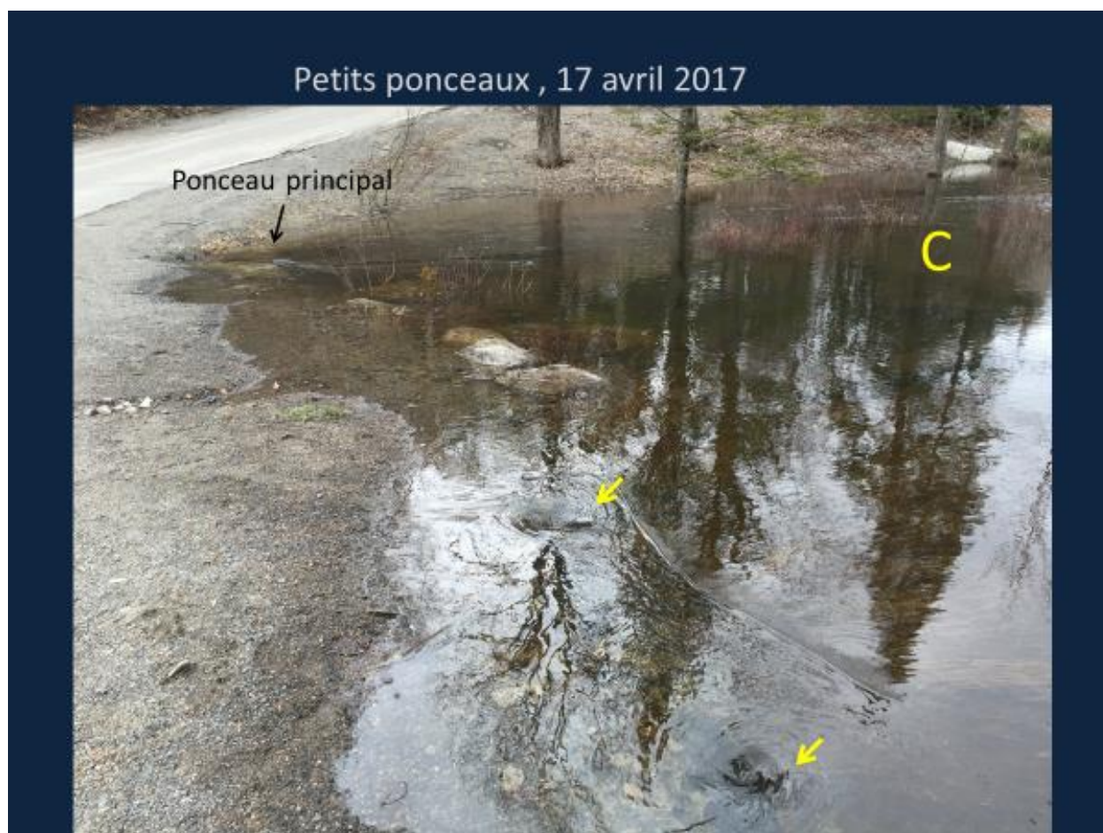
Figure 3 C. Entrées submergées des deux ponceaux secondaires indiquées par les flèches jaunes.
